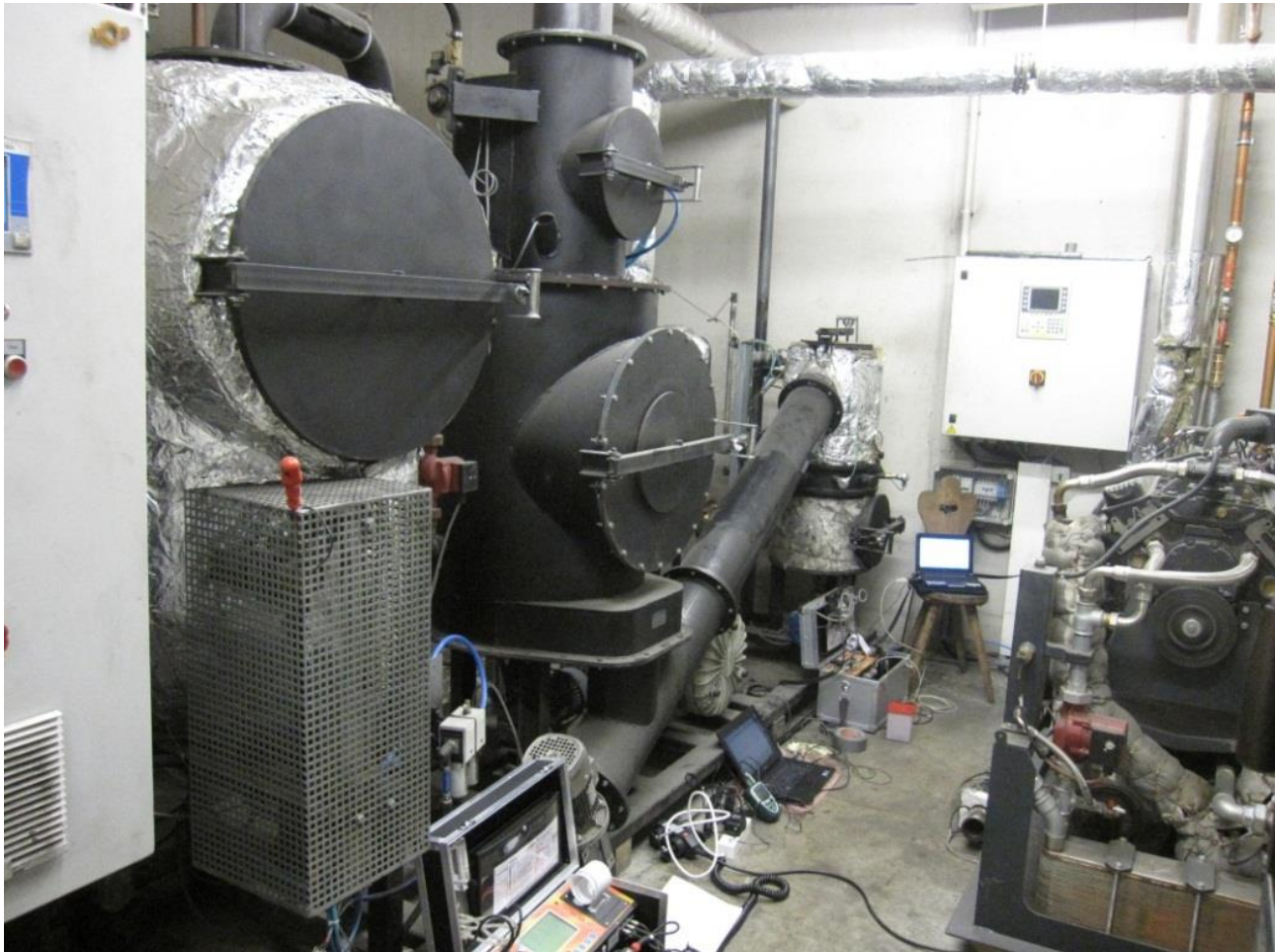
Abbildung 7.1 Holzvergaser-BHKW der Firma Spanner Re 2 GmbH, Anlage A1, © HSZG.
